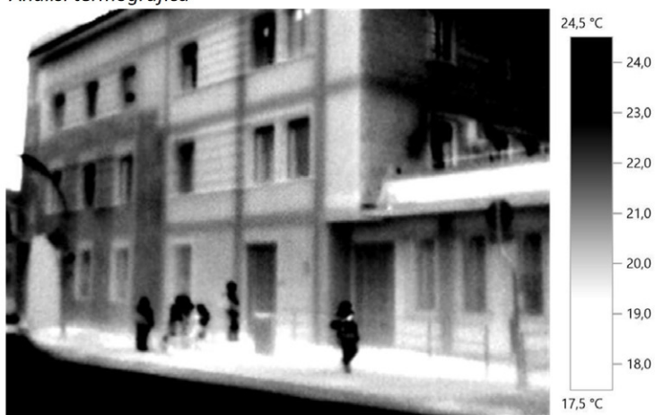
Fig. 4. Esempio di analisi termografica applicata ad una facciata che nasconde un nucleo in muratura portante e addizioni successive con telaio strutturale in calcestruzzo armato (elab. Cantini 2022).
