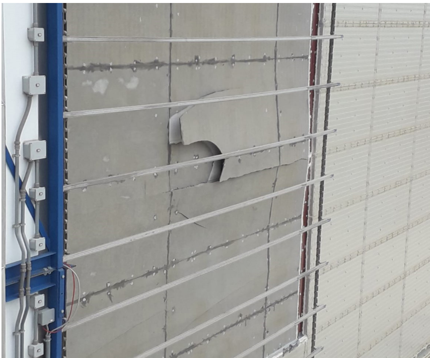
Fig. 35 - Esito simulazione di carico e pressione del vento: Rottura / Wind load and wind pressure simulation result: Breakage (Source: Authors' elaboration).
