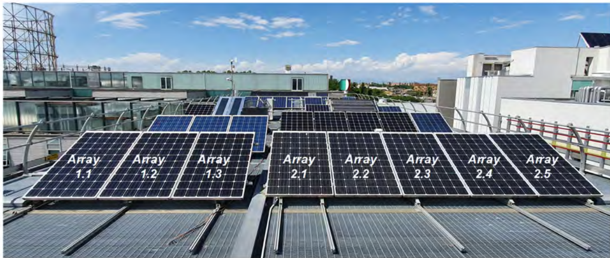
Figure 9. PV modules installed at SolarTech Lab , Politecnico di Milano.
