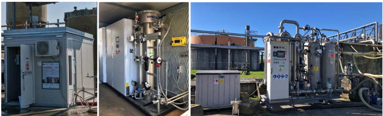
Figura 3. Immagini dell'impianto di ozonolisi integrato al processo di ossidazione biologica. Da sinistra: container contenente il generatore ozono, generatore ozono, reattore di contatto con sistema MIXFLO 3 .
