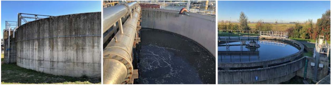
Figura 1. Immagini dell'impianto biologico. Da sinistra: esterno vasca con dettaglio del pozzetto di rilancio del refluo in ingresso e dei fanghi di ricircolo, interno vasca e sedimentatore secondario.
