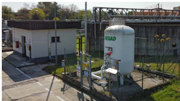
Figura 17. Serbatoio di stoccaggio di ossigeno liquido.
