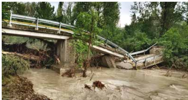
2. Il ponte sul torrente Sillaro in Via Cà Lessio, nei pressi di Monterenzio (BO), crollato per evento di piena a Maggio 2023
