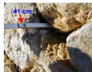
Fig. 18. Ispezione diretta che evidenzia la presenza di un vuoto
