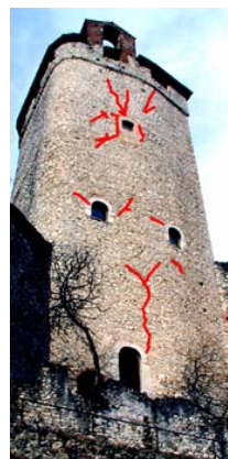
Fig. 10. Quadro fessurativo del Mastio
