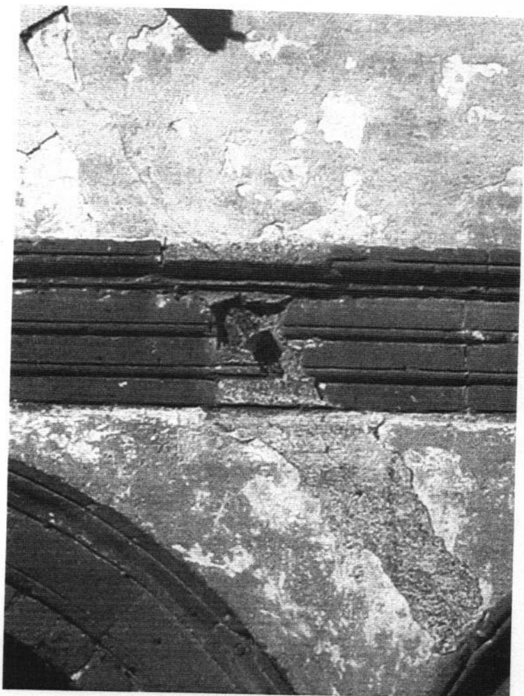
28. Prospetto est, distacco dell'intonaco e perdita di materiale nella fascia marcapiano in laterizio
