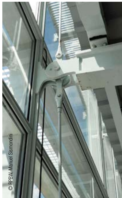
Dettaglio di interfaccia tra l'estremità della travatura a supporto della passerella, la giunzione a cerniera, i cavi tensori e il fissaggio del sistema a doppia parete esterno
