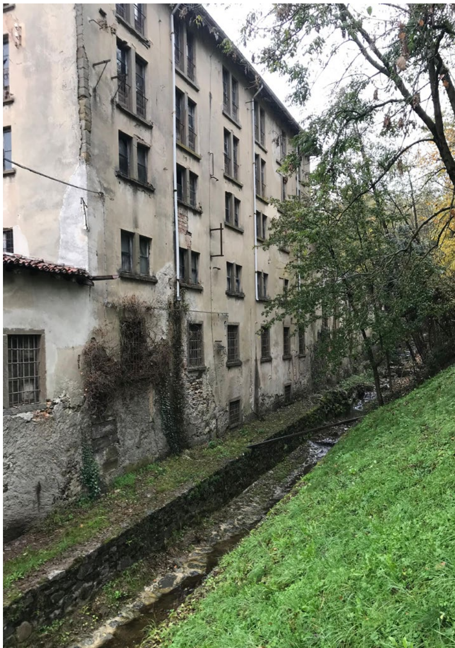
03 – Filatoio della Torre, Ello (Lecco – Valle S. Martino e Valle Imagna), 2022. Foto di F. Vigotti.
