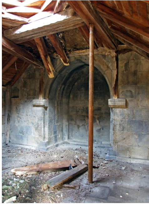
Fig. 2 Monastero di Haghpat, Armenia. Il dissesto della copertura di uno degli edifici del complesso (foto M. Giambruno, 2015).
