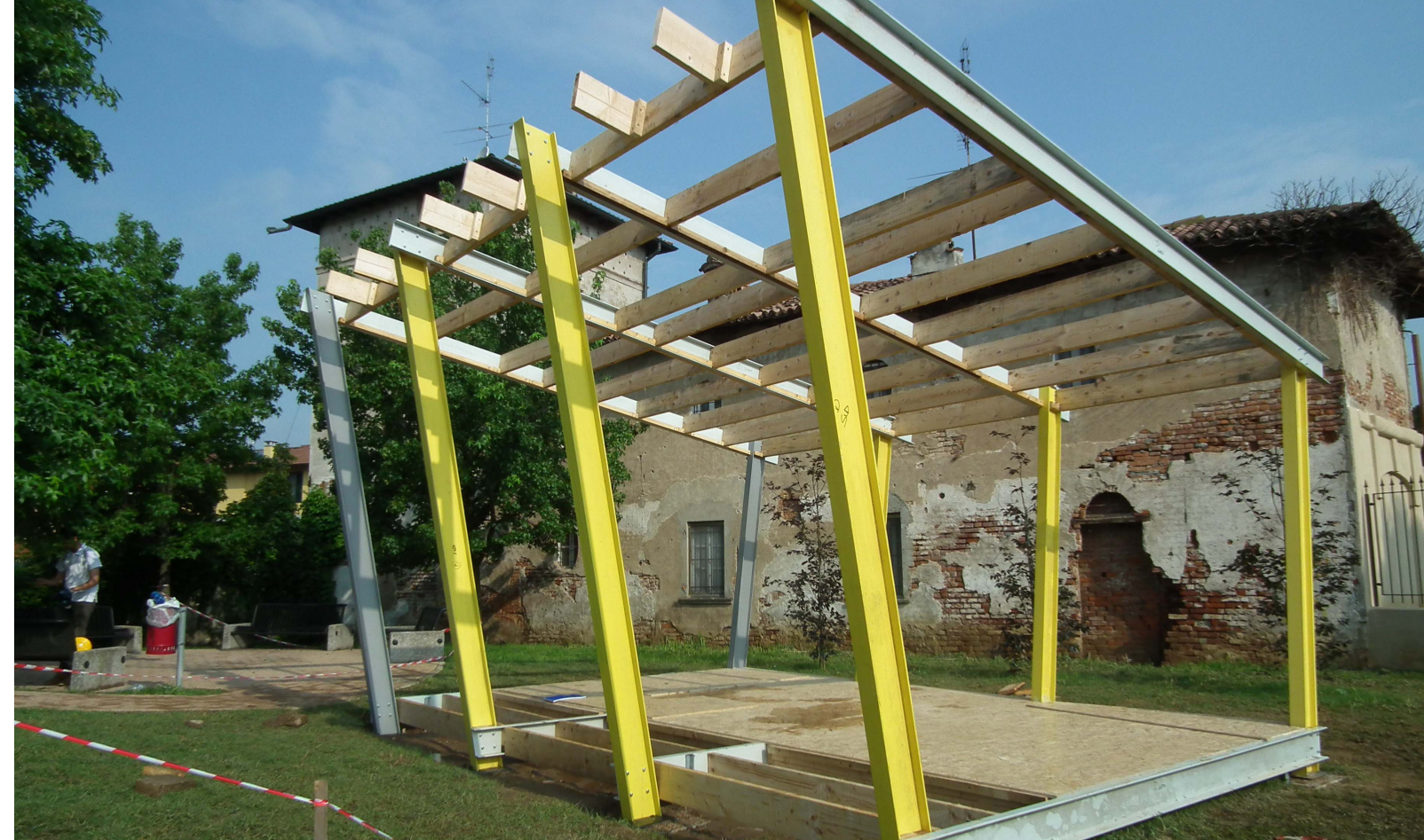
Fig. 2 Modulo Stone 2 realizzato ad Abbiategrasso nel 2014 dagli studenti del Laboratorio di Costruzione 1 della Scuola di Architettura del Politecnico di Milano - prof. A. Rogora e prof. M. Fianchini. Il modulo è realizzando utilizzando un sistema Segal modificato che utilizza elementi strutturali di recupero in fibra di vetro accoppiati ad elementi in legno.
