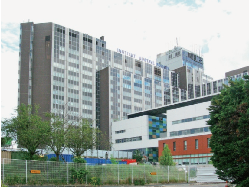
Istituto Gustave Rousseau, Parigi: realizzazione della nuova piastra diagnostica a supporto dell'obsoleto ed energivoro monoblocco
