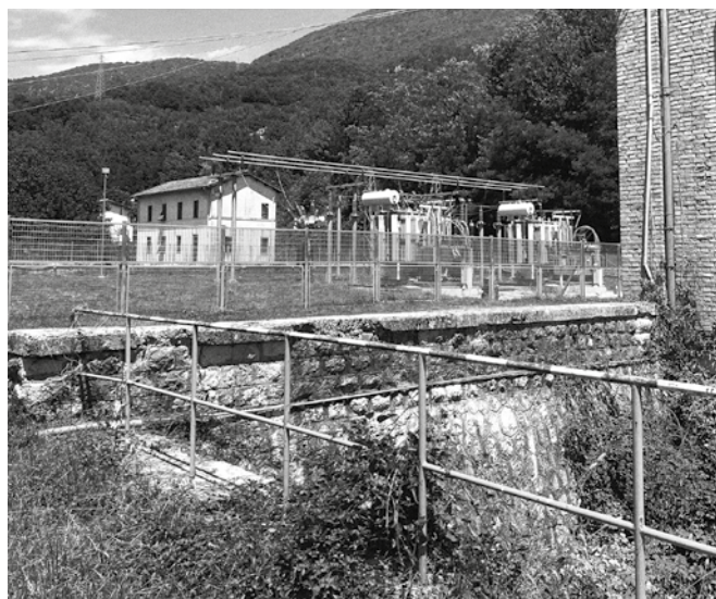
07. Centrale Torlonia di Canistro: in primo piano, il parapetto degradato attorno al canale di scarico; dietro, la stazione di trasformazione e la vecchia casa dei dipendenti, oggi abbandonata | The Torlonia power house in Canistro: in the foreground, the decayed railings around the drainage channel; behind, the transformer station and the old employees' house, now abandoned. G. Azzini
