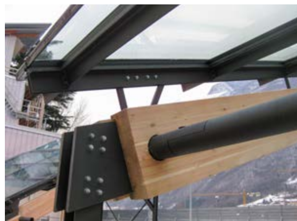
7 Pratica di "disvelamento poetico": visualizzazione, in forma "reale" e "concreta", dei contenuti tecnici attraverso la "formazione modellizzata" delle interfacce esecutive (senza "esperienza" o "visione" diretta del fenomeno) (Sidell Gibson Architects, One Snow Hill Building, Birmingham) ©Focchi Group
