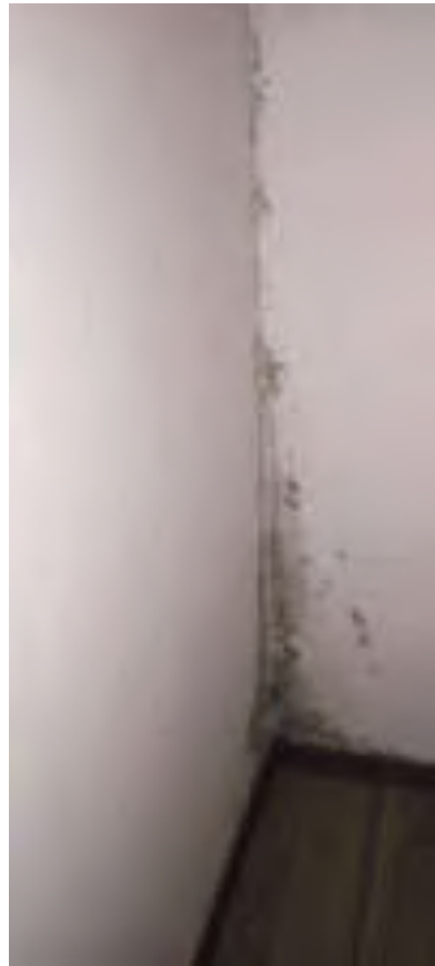
Fig. 7.1: Esempio di efflorescenza su una muratura interna causata da un cattivo isolamento dell'involucro perimetrale. Nei punti più freddi della muratura si ha una tendenza alla formazione di muffe diffuse.
