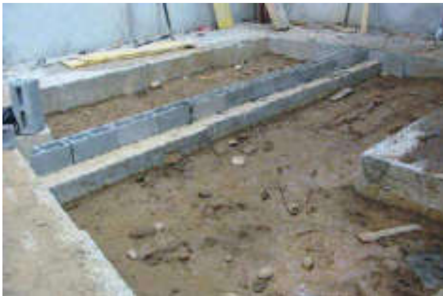
Fig. 5.30: Vespaio a secco: posa dei mattoni semi-pieni per la realizzazione dei muretti.
