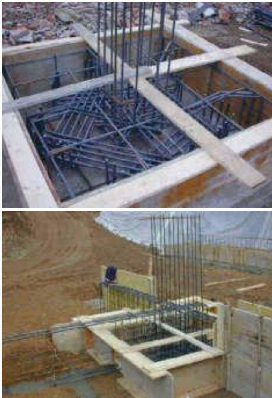
Fig. 5.11: Plinto di fondazione con ferri di ripresa per la realizzazione del pilastro.
