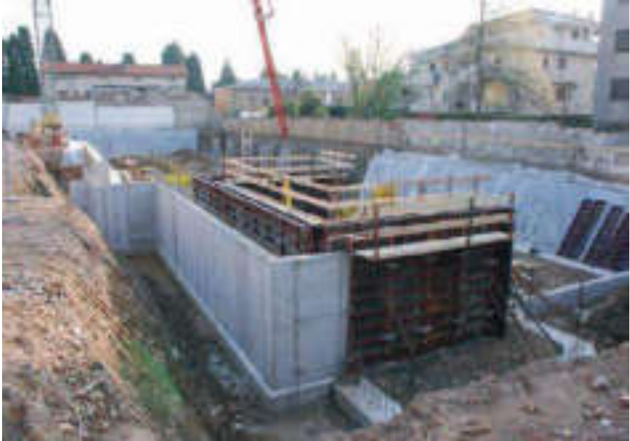
Fig. 5.29: Realizzazione dello scavo di fondazione in terreno sciolto (inclinazione di 135°) e muro contro terra di calcestruzzo armato.
