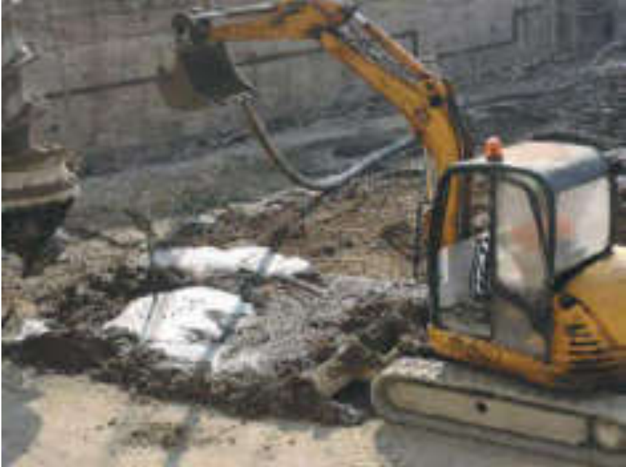
Fig. 5.19: Inserimento del calcestruzzo ad impasto fluido (vibrato e compattato) nel foro praticato dalla trivella dove sono stati collocati preventivamente i ferri d'armatura. Cantiere: Campus di Architettura di via Bonardi, Politecnico di Milano.
