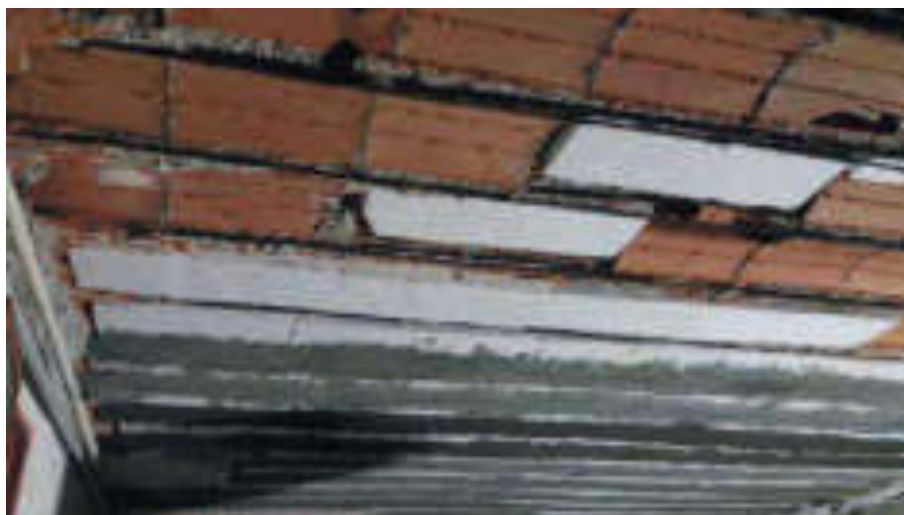
Fig. 8.11: Sfondellamento di un solaio realizzato con pignatte e travetti.
