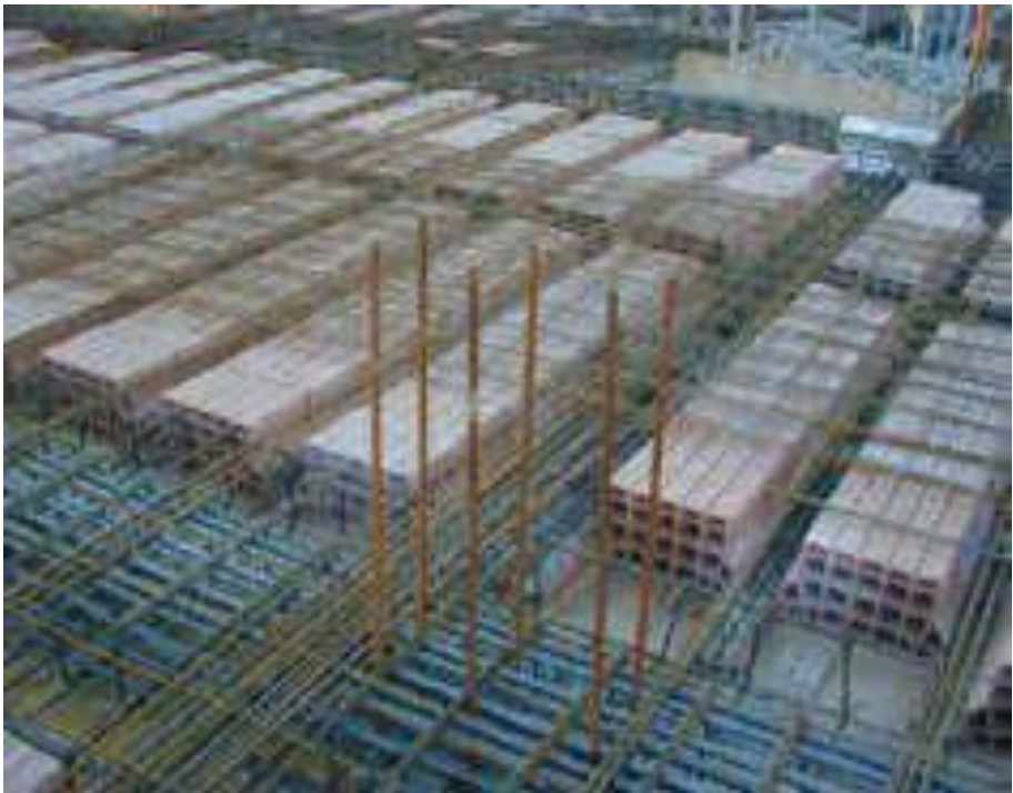
Fig. 8.10: Solaio di latero-cemento gettato in opera con travetti tralicciati e fondello di laterizio.
