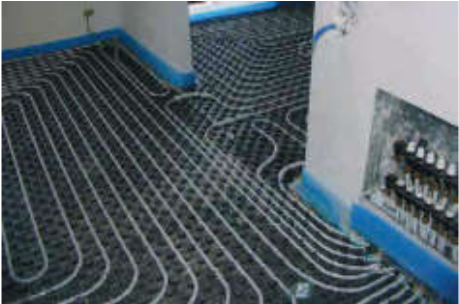
Fig. 8.21: Particolare di un impianto di riscaldamento a pannelli radianti posato a spirale. A destra il collettore.
