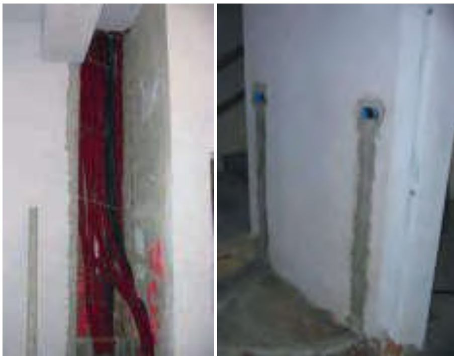
Fig. 11.30: A sinistra cavi che passano nelle pareti (passaggio in traccia); a destra terminali dell'impianto elettrico (interruttori).
