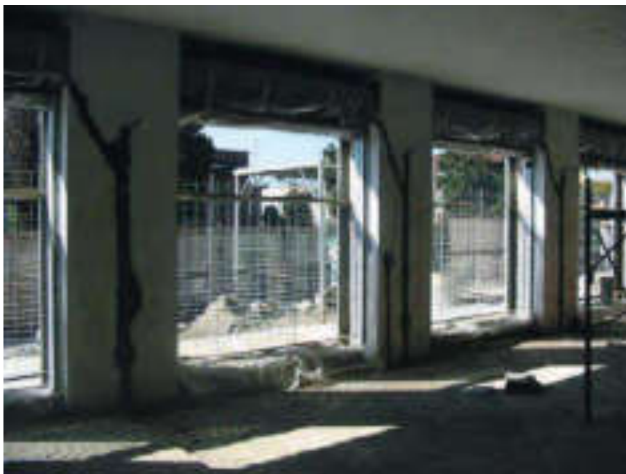
Fig. 11.31: Impianto di automazione sotto traccia per serrande avvolgibili.
