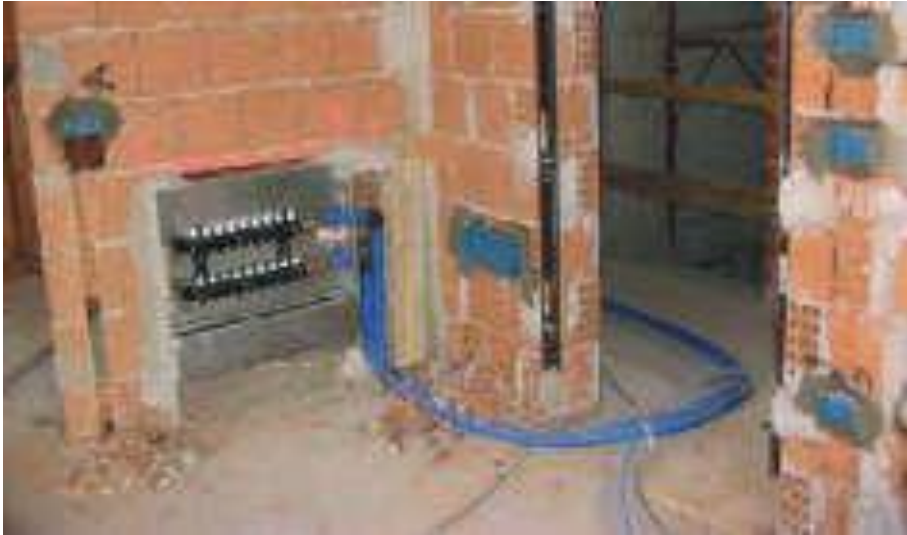
Fig. 11.4: Collettore installato in un contesto condominiale.
