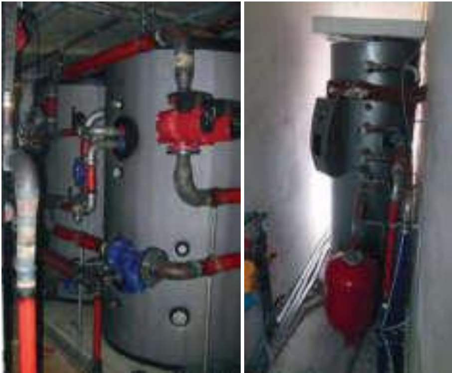
Fig. 11.3: Centrale termica di un condominio posta all'interno di un locale interrato, posizionato sotto l'edificio.
