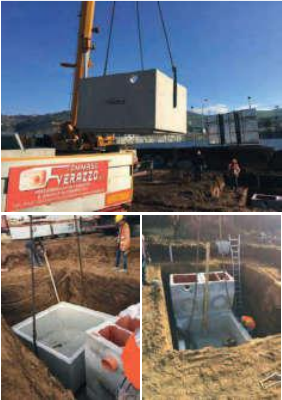
Fig. 11.24: Realizzazione di un impianto di prima pioggia, Lidl in Via borsellino a Caserta. Fonte: Tommaso Verazzo S.r.l. Costruzioni e prefabbricati in cemento.
