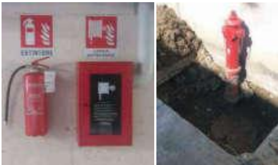
Fig. 11.27: A sinistra: esempio di posizionamento estintore e lancia antincendio: L'estintore ha un tempo di utilizzo di massimo 20 secondi mentre la lancia è a durata illimitata perché collegata alla riserva idrica. A destra: idrante a colonna posizionato all'esterno dell'edificio.
