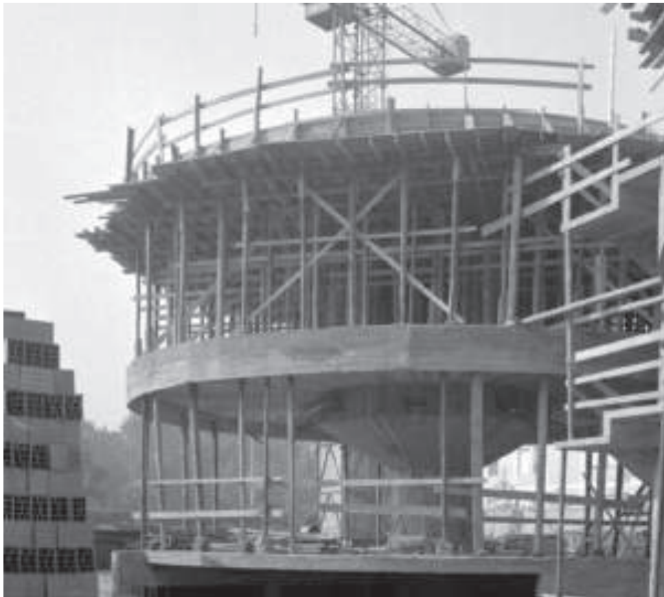
Fig. 3.12: Edificio in via Gavirate: fotografia di cantiere: particolare delle solette circolari a sbalzo. Fonte: Studio Mangiarotti.
