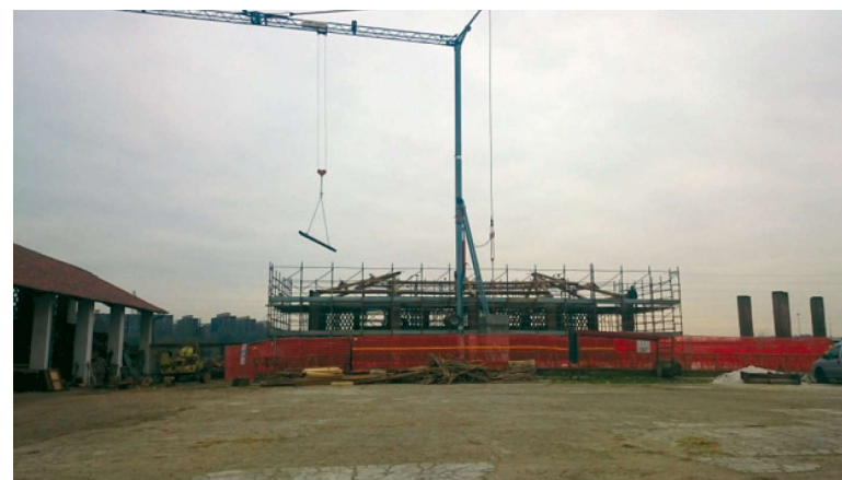
Photos 7 et 8. Municipalité de Milan, travaux d'entretien exceptionnels à faire et en cours. En haut, nécessité de renforcement, nettoyage et protection de la façade; en bas, travaux de substitution du toit (cl. E. Colli)
