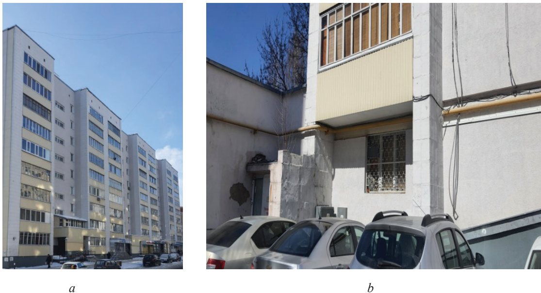
Рис. 6. Эстетические дефекты комплексного решения по ремонту фасада жилого дома по адресу: Казань, ул. Вишневского, д. 53 — отсутствие утепления лоджий (а) и мест прокладки инженерных сетей (b) (источник: исследование авторов)
