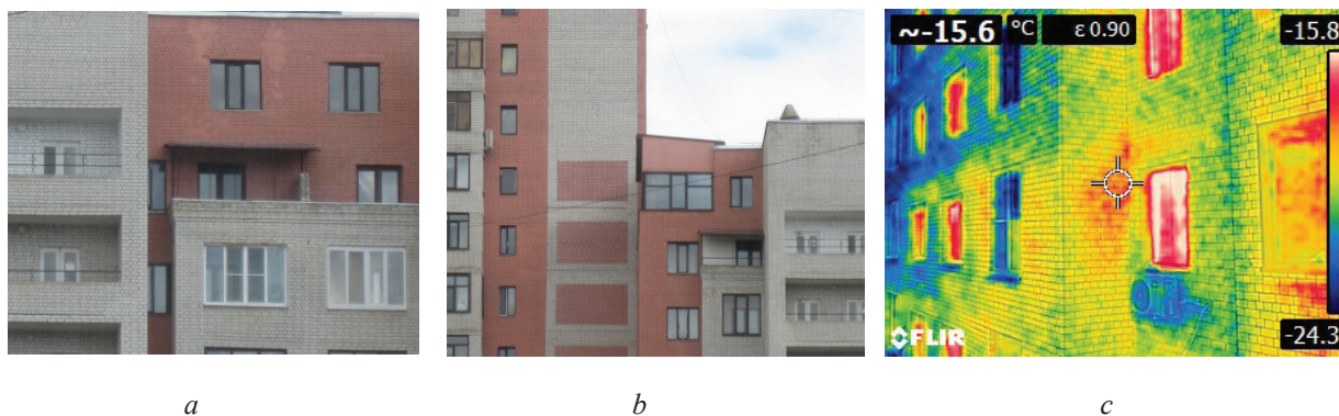
Рис. 10. Внешние эстетические и внутренние технические дефекты жилого дома, ставшие результатами стихийной реконструкции: a — балкона; b — новые объекты на плоской крыше; c — фиксация теплопотерь от некачественного внутреннего утепления стен и присоединенных лоджий (источник: исследование авторов, термограмма авторов)
