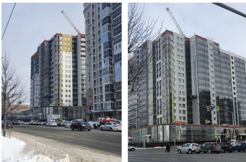
Рис. 4. Модерация недостроенного жилого дома новым застройщиком и проведение работ по дополнительному внешнему утеплению фасада в дополнение к внутреннему утеплению стен и ограждающих конструкций. Дом расположен по адресу: г. Казань, ул. Достоевского, д. 57 (источник: исследование авторов)
