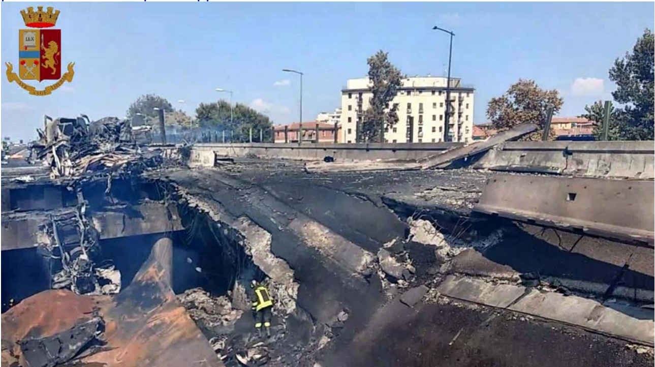
Figure 11 Le viaduc routier après l'explosion
