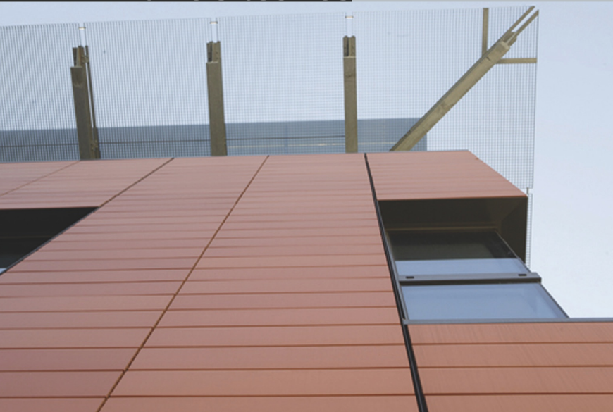
Immagine 7. Elaborazione esecutiva e procedure applicative delle interfacce relative alla componentistica in cotto in accordo alla resistenza alle dilatazioni dovute all'umidità, all'assorbimento d'acqua, alle efflorescenze, al gelo e agli urti, alle sollecitazioni eoliche (in pressione e in depressione; produzione Piterak)
