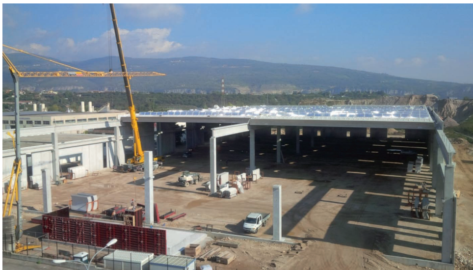
Montaggio di un edificio Ondal® con tegoli di 41 m (cortesia di A. Basso)
