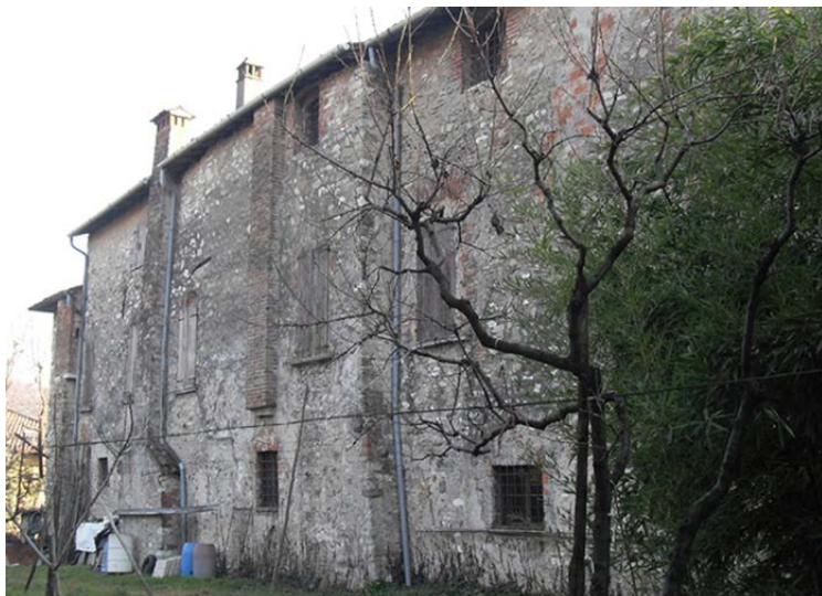
Figura 11. Gussago, Brescia, cascina in località Lóc de la Begia. È interessante rilevare la stratificazione dei sistemi di riscaldamento aggiunti in vari tempi, addossati alla muratura principale (foto B. Scala).
