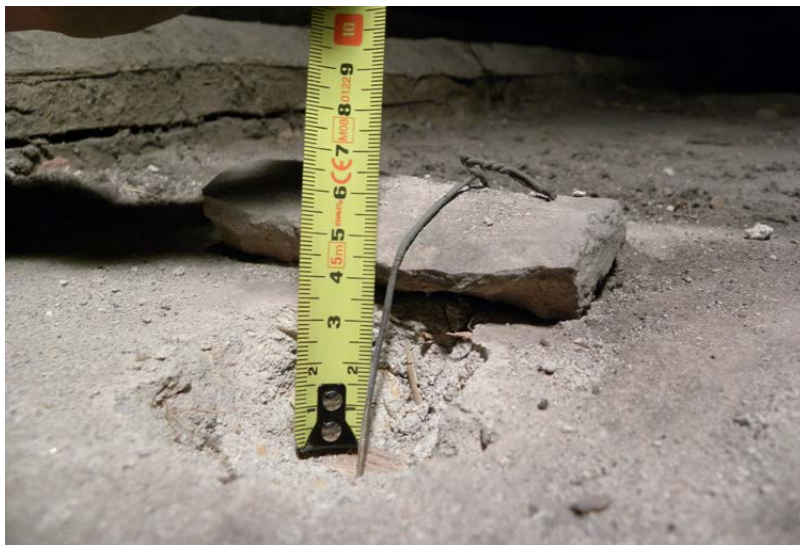
Figura 31. Legaccio in ferro a sostegno del controsoffitto in canne (foto A. Fontanini).
