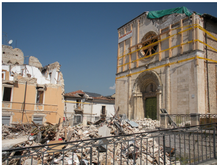
Fig. 5. L'Aquila, piazza S. Pietro di Coppito: la situazione dopo il terremoto (foto C. Bartolomucci 2009).
