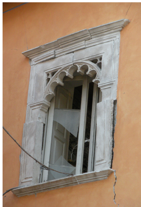
Fig. 2. I dissesti sulle cornici lapidee di un edificio in via dei Setaioli a L'Aquila evidenziano probabili ricomposizioni precedenti (foto C. Bartolomucci 2009).
