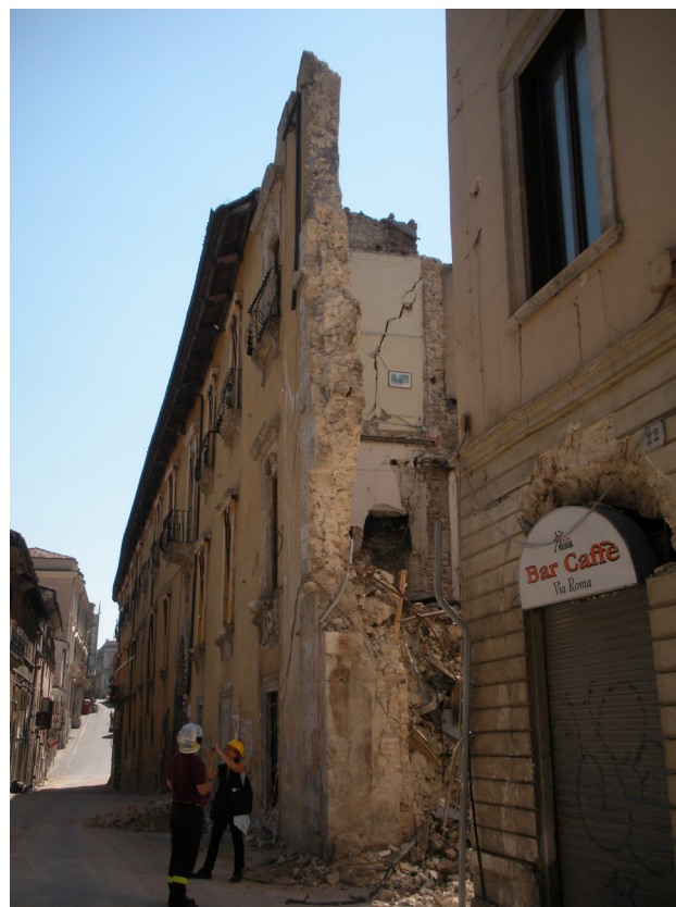
Fig. 9. L'Aquila: Palazzo Carli all'Annunziata, nonostante il crollo localizzato, il fronte di su via Roma mostra la compattezza della muratura residua (foto C. Bartolomucci 2009).
