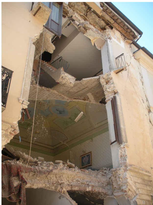
Fig. 8. L'Aquila: alcuni crolli puntuali di edifici storici (via Roma) sembrano dovuti a situazioni di vulnerabilità innescate da interventi incongrui, vedi la scala in c.a. poggiata su una volta di mattoni in foglio (foto C. Bartolomucci 2009).
